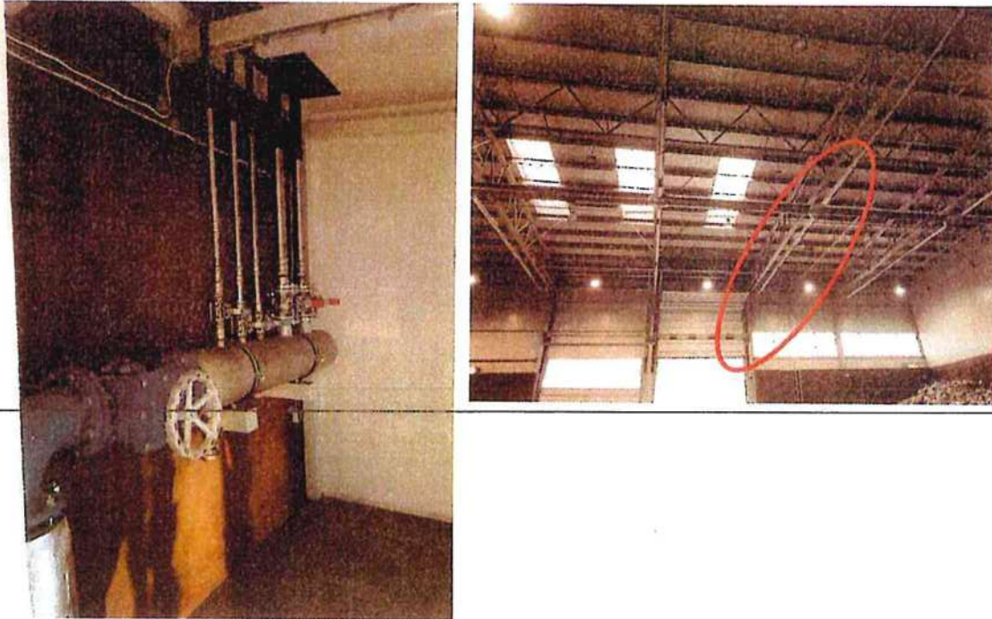
Ryc. nr 5. Instalacja zraszaczowa wraz z pomieszczeniem technicznym
